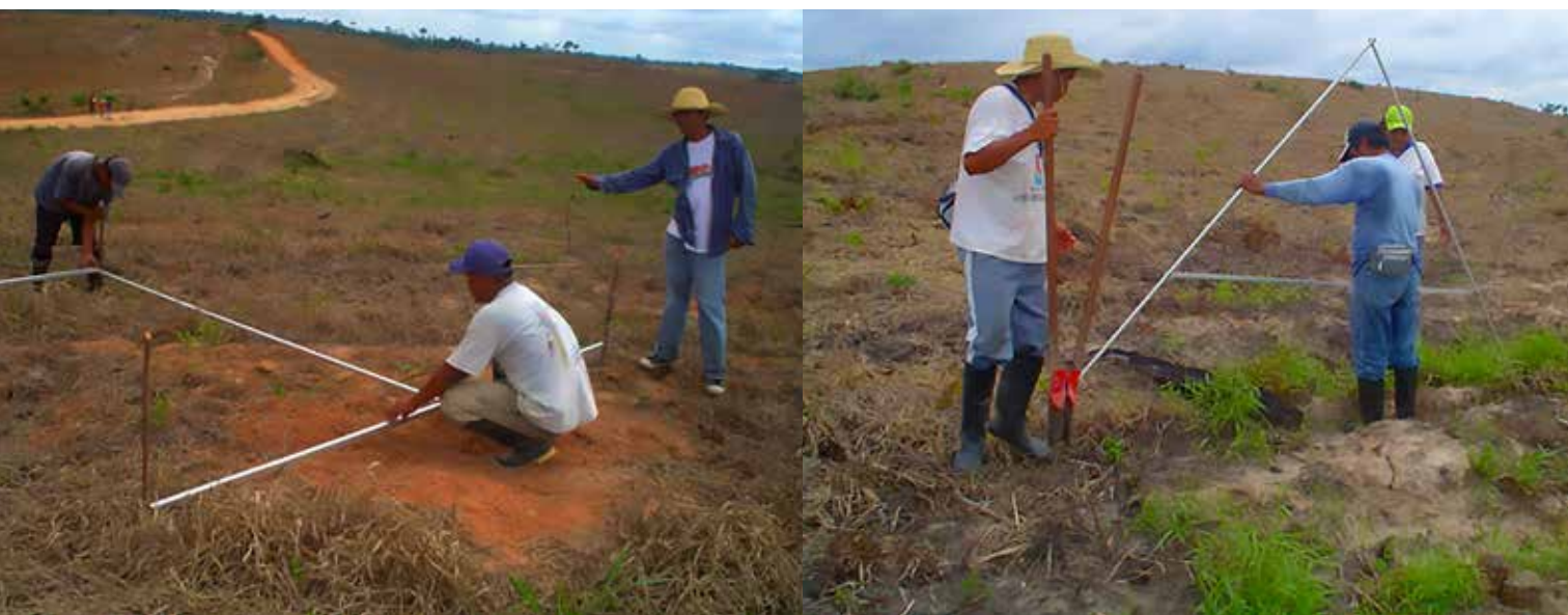
Figura 21. Alineado con perfiles de aluminio: En varas (izquierda) y nivel A (derecha)
